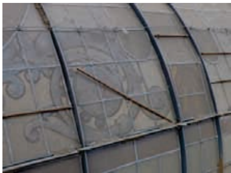
Elementos estructurales desposicionados
