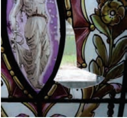
Sector con faltante de vidrio
