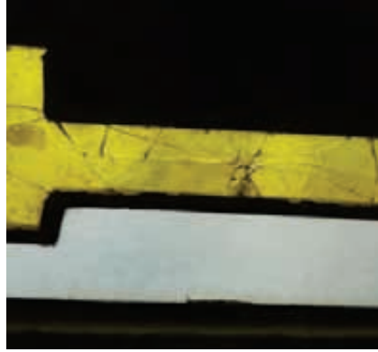
Fracturas, astillamientos en vidrio
