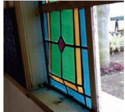
Deformación, abombamiento de paneles
