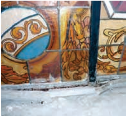
Corrosión de la estructura metálica y desprendimiento como patología derivada de la corrosión.
