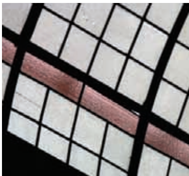
Desplazamiento de vidrios
